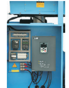
空压机 Air compressor
