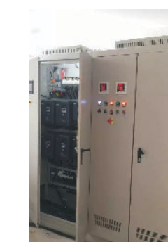
污泥燃烧系统 Sludge combustion system
