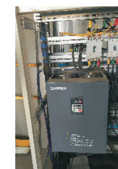
消防供水 Fire water supply
